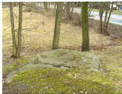
Fot. 30. Schron (3a), widok na strop od południa. Widoczne niesymetryczne rozszerzenie i pęknięcia, wejście zasypane.
