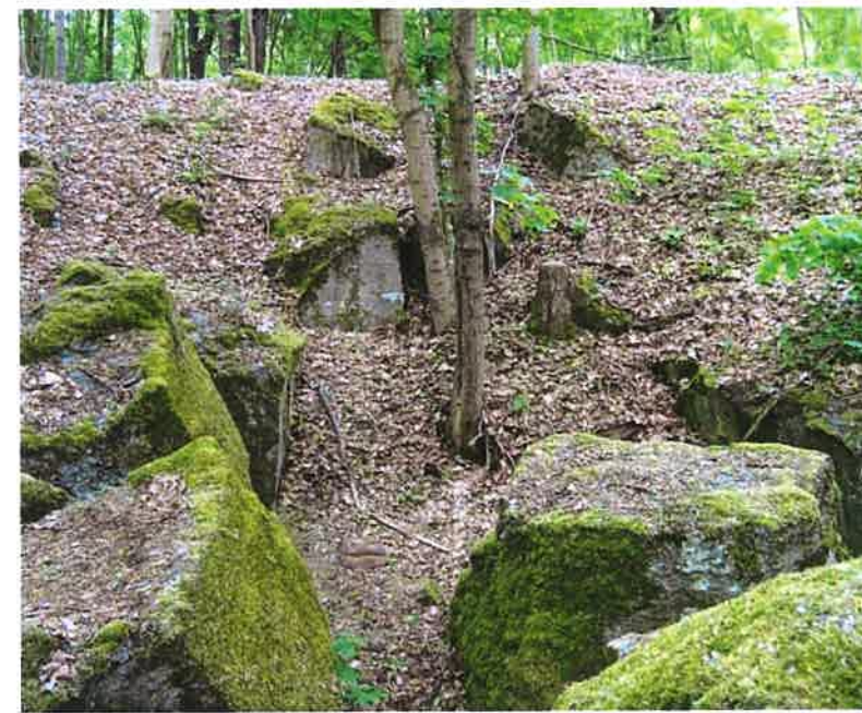
Fot. 21. Widok od zachodu na wewnątrz schronu (2e): na pierwszym planie fragmenty tylnej ściany i sklepienia, za nimi zasypane częściowo wnętrza i popękane ściany – boczne i na wprost czołowa, ze śladem łuku sklepienia, wokół rozrzucone fragmenty sklepienia. Widać duże zagłębienie schronu względem szczytu wzniesienia.
