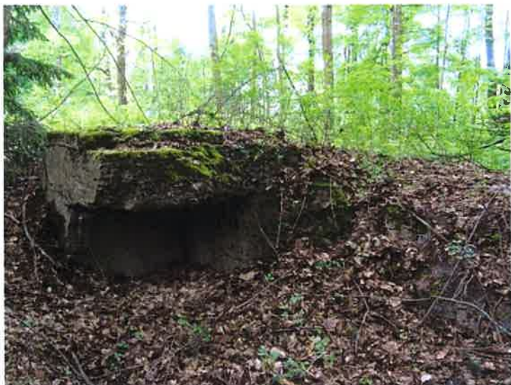
Fot. 10. Stanowisko (1k) - ściany i fragment nakrywającego niszę stropu o konstrukcji żelbetowej, z widocznymi prętami zbrojenia, nieznacznie wystające nad ziemne przedpiersie rowu strzeleckiego.
