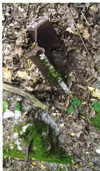
Fot. 12. Schron (2a) – szyna kolejowa i pręty zbrojenia w tylnej ścianie.
